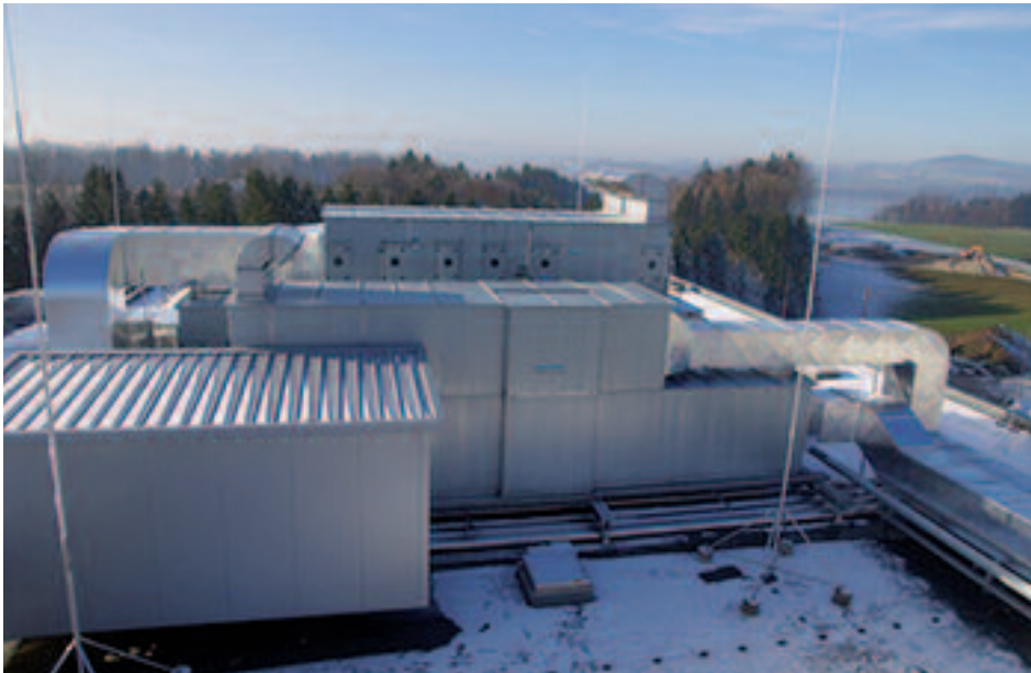
Lüftungsaggregate in Hygieneausführung für Produktion und Verpackung.
